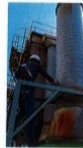
Blower เครื่องรีดท่อ 1
